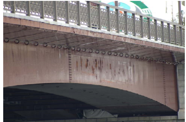
写真-3 塗膜の劣化
