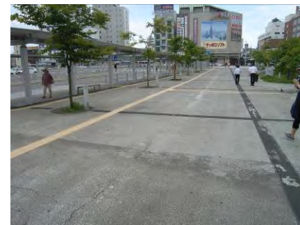
写真-11 施工管理、品質管理の不徹底から 表面が劣化したと考えられる舗装 (北海道)
