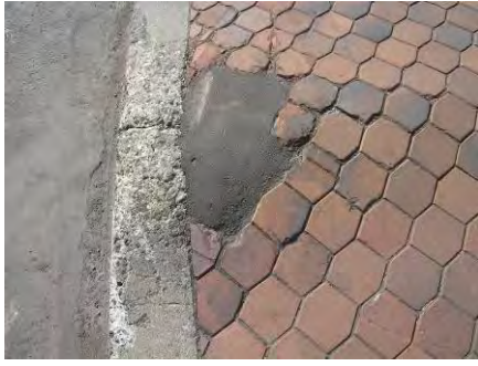
写真-13 除雪による舗装の損傷（北海道）
