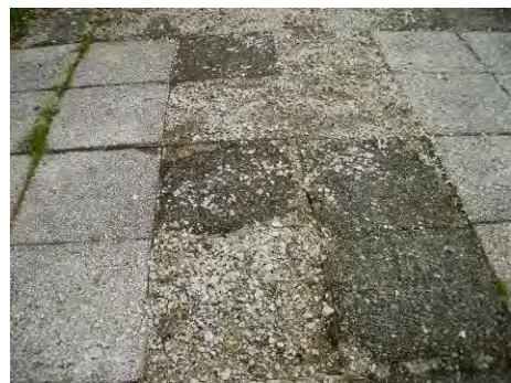
写真-2 劣化したブロック舗装 (北海道)
