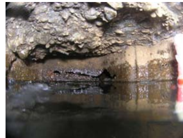
写真-3 既設鋼矢板 損傷状況
