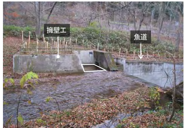
写真-3 擁壁工が水制工として機能し土砂堆積が抑制
