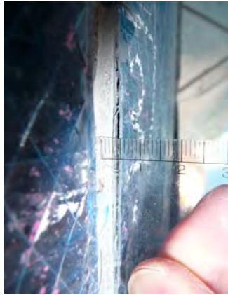
写真-10 シートの剥離状況
