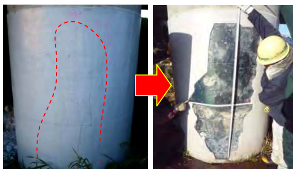
写真-4 保護材の変状状況と浮きはつきり後状況
