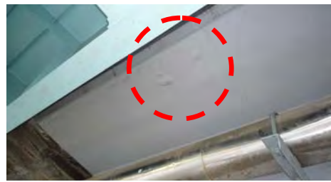
写真-2 目視で確認できる「浮き」
