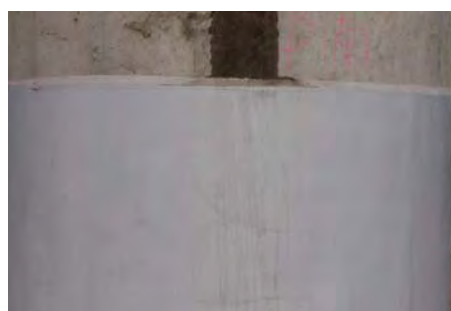
写真-8 ひび割れた保護材の表面を伝う水の状況 (写真-7の点線部拡大)
