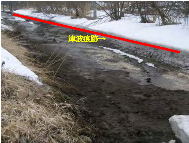
写真-1 大津市街樋門 堤内の津波痕跡
