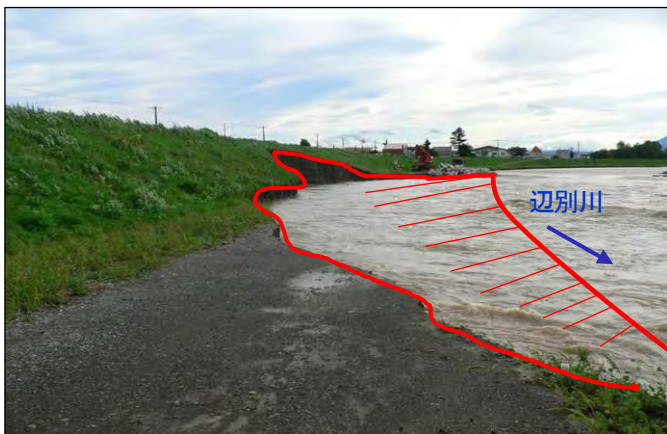
写真-2 辺別川 KP0.6 付近被災状況
