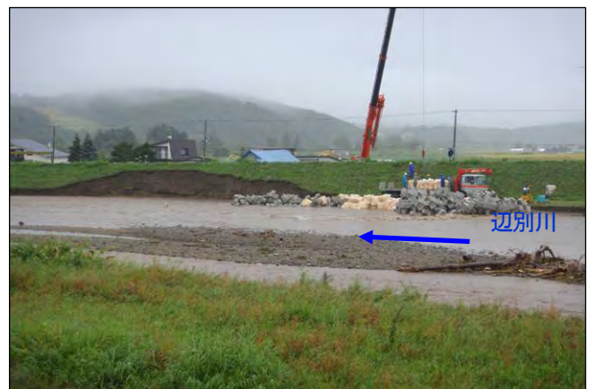
写真-3 辺別川 KP0.6 付近被災状況
