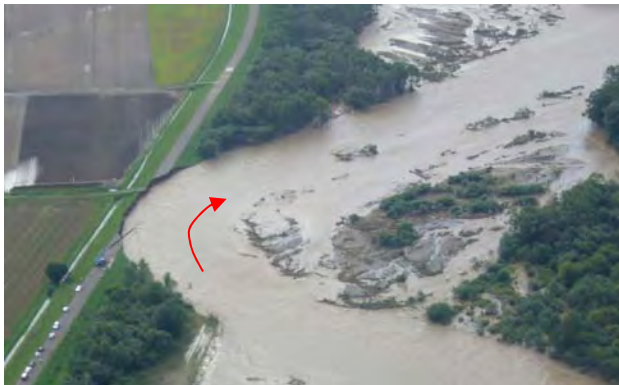
写真-4-3 堤防一部流出箇所付近 (上流側から撮影。H23.9.7 AM10:38 撮影)
