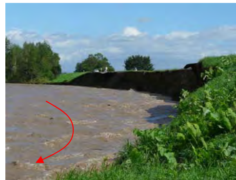
写真-4-2 KP18.2 堤防一部流出箇所 (下流側から撮影。H23.9.7 AM9:24撮影)
