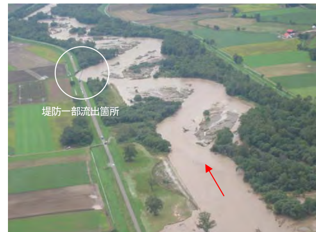
写真-1-1 堤防一部流出箇所全景 (上流側から撮影。H23.9.7 PM1:49 撮影)
