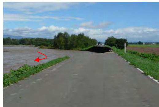
写真-4-1 堤防一部流出箇所 (下側から撮影。H23.9.7 AM9:38撮影)
