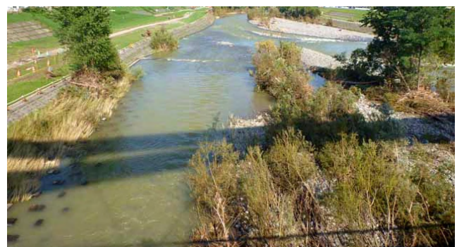
図-8 出水後の状況（水穂大橋下流）
