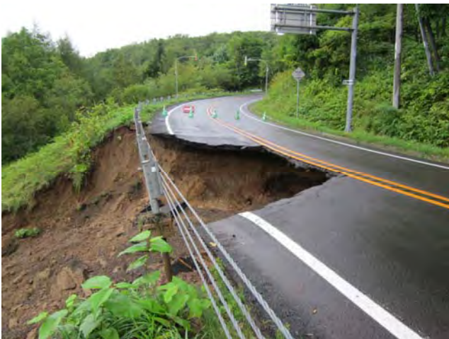
写真-2 9月6日 通行止め時の状況
