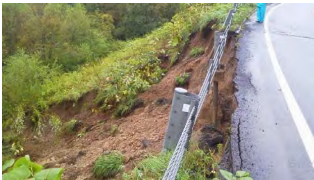
写真-1 9月6日 事象発生時の状況
