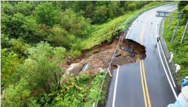
写真-4 盛土崩壊状況
