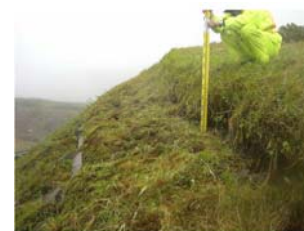
写真-3 法肩の段差
