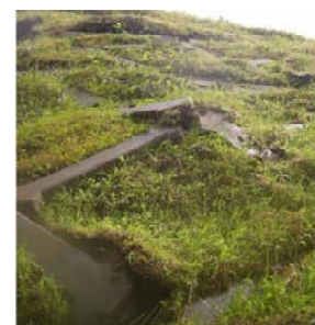
写真-4 既設法枠の変状
