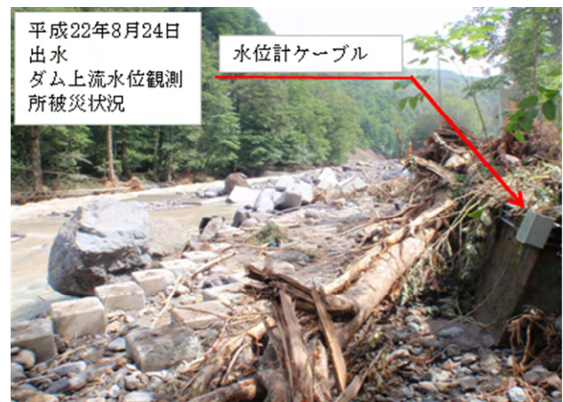
写真-3 水位観測所被災状況
