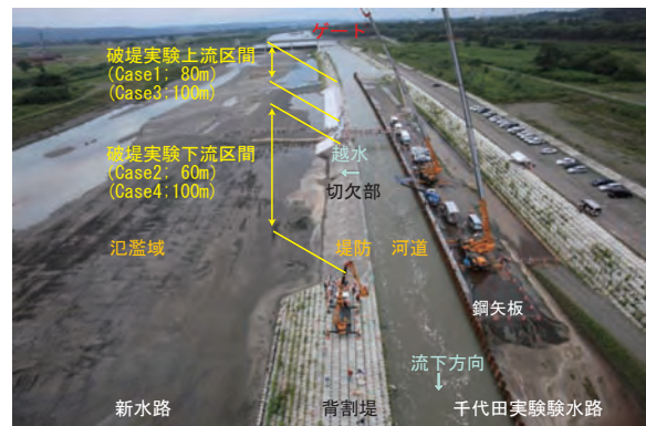
図-1 千代田実験水路内における越水破堤実験の様子
