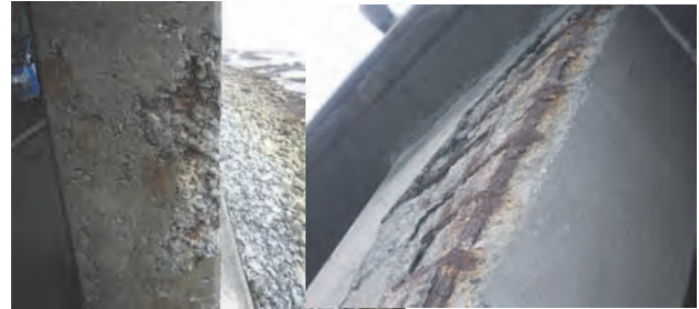
写真-10 過去の点検記録に記載の損傷状況
