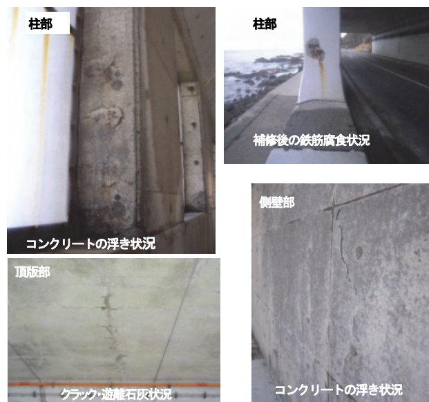
写真-7 日本海側の覆道の損傷状況
