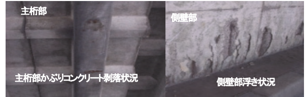
写真-9 太平洋側の覆道の損傷状況
