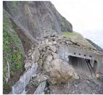
写真-1 落石による道路災害例(2008)
