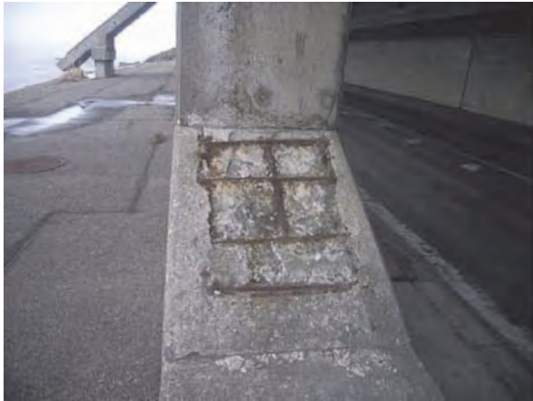
写真-8 覆道柱部の損傷状況（鉄筋露出）
