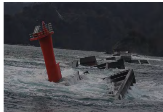
写真-2 被災状況(釜石港湾口防波堤 北堤) 2)
