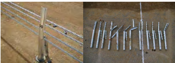
写真-12 衝突後の支柱の破損状況
