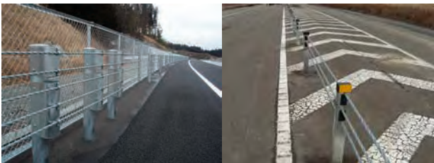
写真-2 ガードケーブル（左）とワイヤーロープ式防護柵（右）
