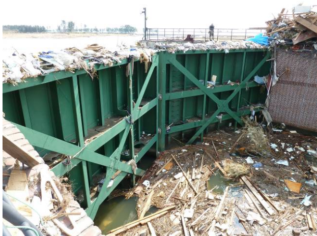
写真- 6 損壊した樋門等の調査（北上川下流）
