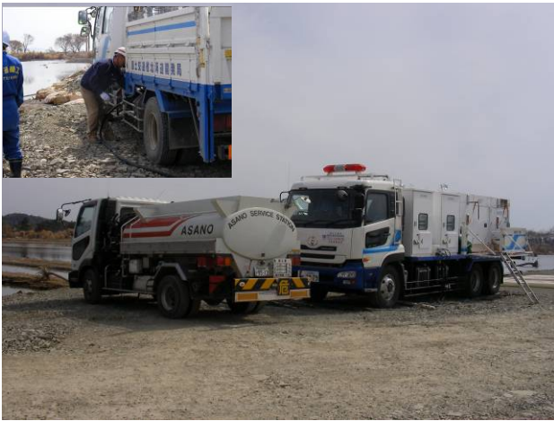
写真-8 ローリーから排水ポンプ車への燃料供給
