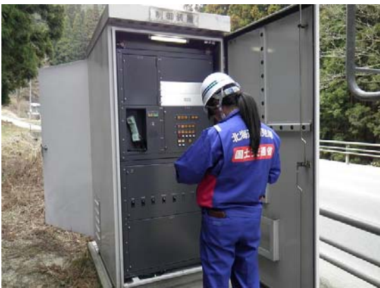
(e)三陸国道事務所管内国道トンネル設備7カ所点検支援 4月7日第4班
