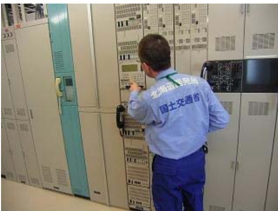
(d)三陸国道事務所管内多重無線中継所6カ所点検支援 3月31日から4月12日まで第3班、第4班
