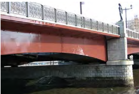
図3-1 幣舞橋の船衝突による損傷
