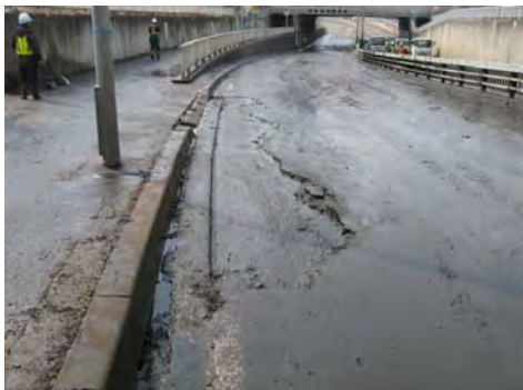
図 5-15 舗装損傷状況
