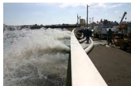
図5-5 排水ポンプ排水状況
