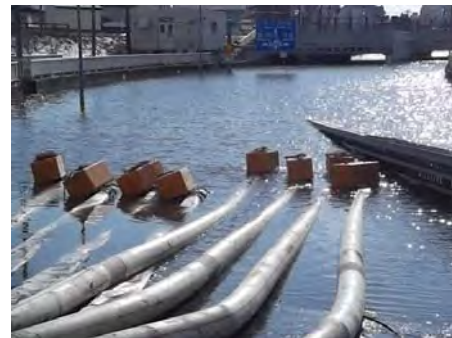
図5-4 排水ポンプ設置状況
