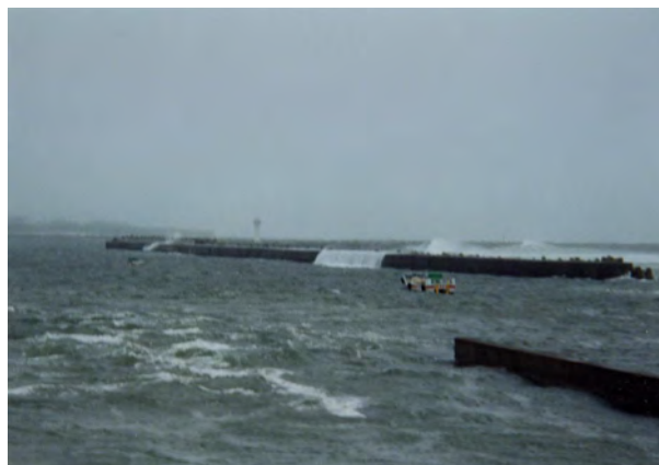
図-12 歯舞漁港 南防波堤越波状況
