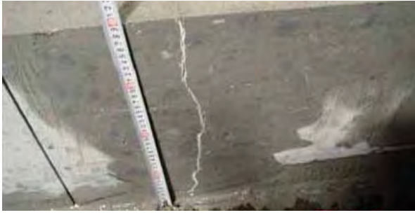
写真-4 クラック貫通状況
