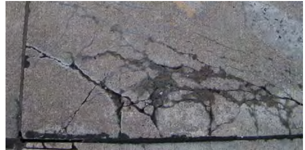
写真-2 エプロン劣化状況(亀甲状クラック)
