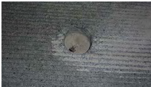
写真-13 跡埋め材の剥離状況 (PC版)
