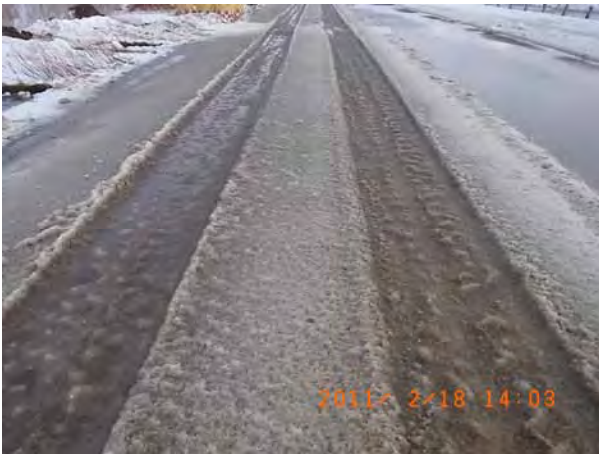
写真-3 ダンプ走行250台通過後の路面状況
