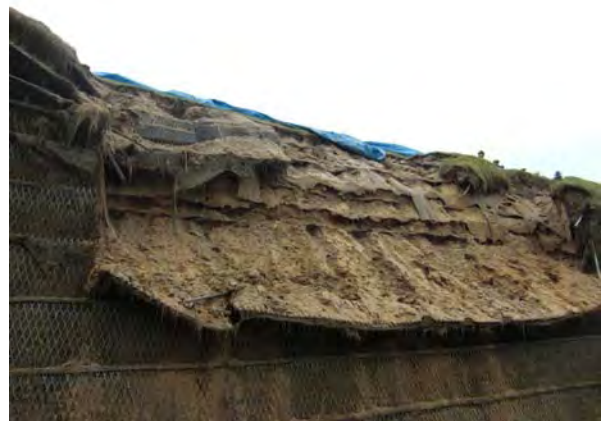
写真-1 補強土壁の変状事例
