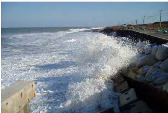
写真-1 海岸洗掘状況
