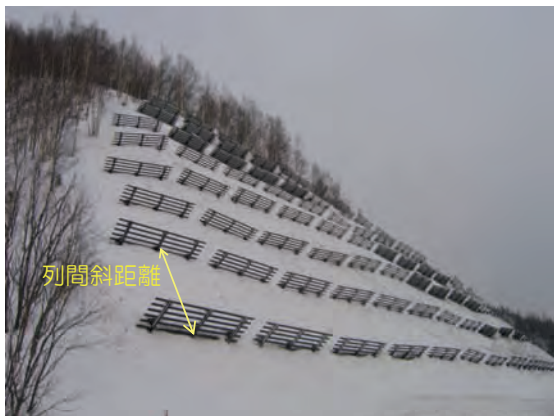
図-1 雪崩予防柵(吊柵)の設置状況の例
