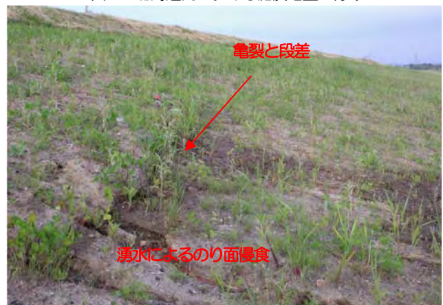
写真-1 間隙水圧の上昇による変状発生例
