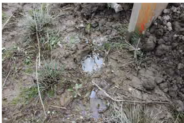
写真-2 施工速度 10cm/日盛土の周辺で確認された水の染み出し
