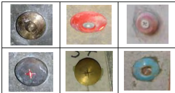
写真-14 実樋門に設置されている測定鈎
