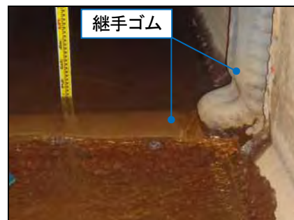
写真-12 函体継手ゴムの変形で生じた段差 (H=120mm)
