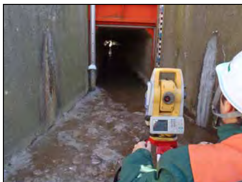
写真-7 函体内の変位計測装置をTSで視準している状況
