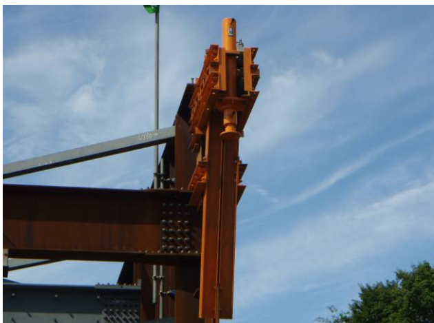
写真-3 宿主別橋上部桁先端部
