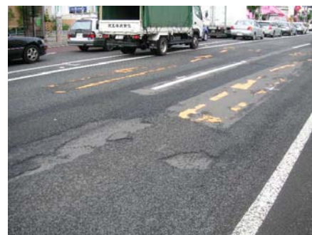
写真-1 排水性舗装の破損状況
