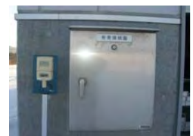
写真-2 発発接続盤
