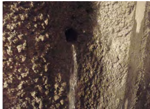
写真-4 ロックボルト孔からの湧水
