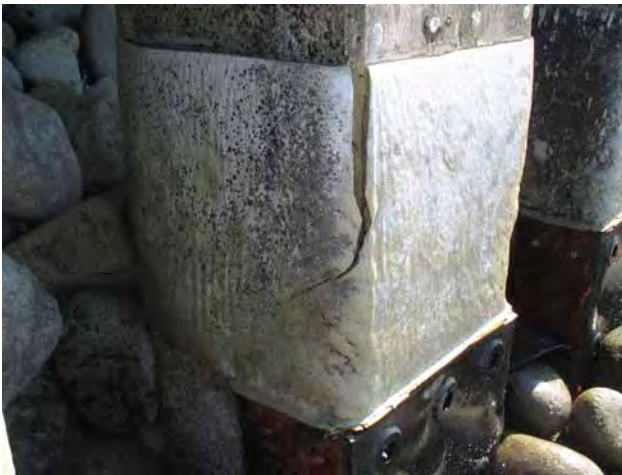
写真-7 ウレタン被覆材が裂き劣化した脚柱の一例
