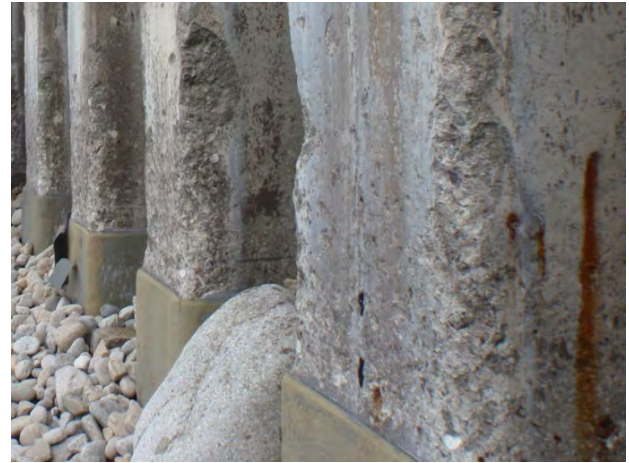
写真-2 コンクリート面の劣化状況
