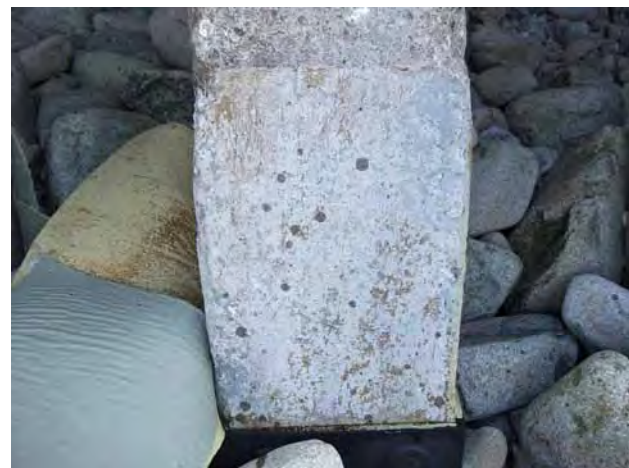
写真-4 ウレタン被覆材が剥離損失した脚柱のコンクリート面(1)
