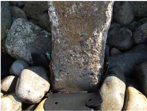
写真-5 ウレタン被覆材が剥離損失した脚柱のコンクリート面(2)
