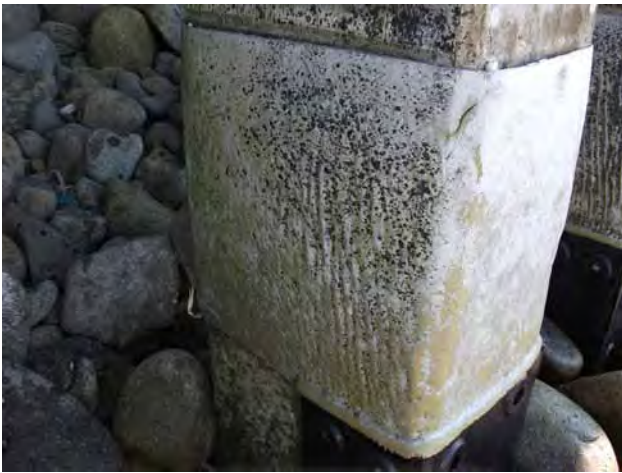
写真-6 ウレタン被覆材が浮き劣化した脚柱の一例
