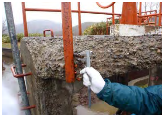
写真-4 スケーリングおよび鉄筋露出の状況（No.1分水門）
