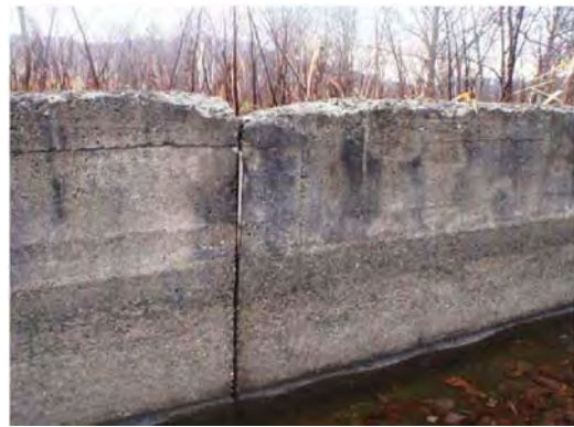
写真-3 開水路側壁天端のポップアウト状況
