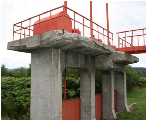
写真-10 操作台の劣化状況 (C 樋門)
