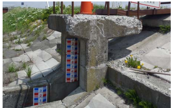
写真-8 操作台の劣化状況 (A 樋門)
