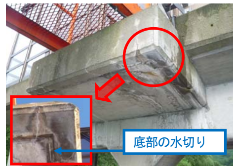
写真-3 底部水切り部の劣化状況の例
