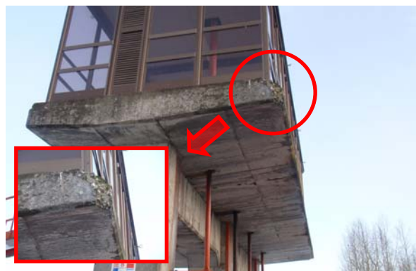
写真-9 操作台の劣化状況 (B 樋門)
