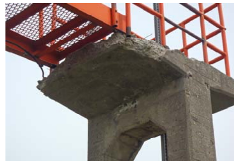
写真-2 操作台の凍害劣化損傷事例
