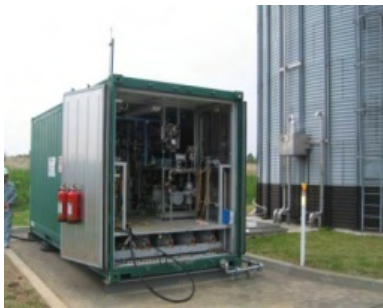
写真-1 バイオガス精製圧縮充填装置
