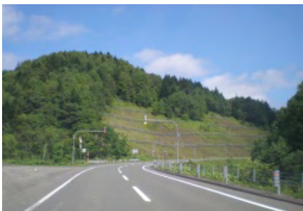
写真-1 植生遷移が進まない切土のり面
