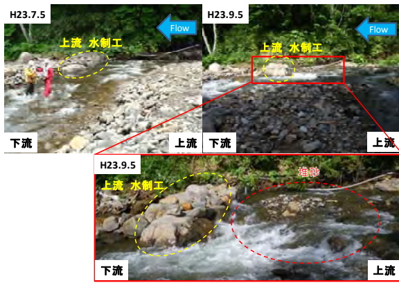
写真-2 上流水制工 直上流の土砂堆積状況
