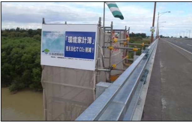
写真-1 一般国道12号江別大橋での掲示 「一般国道12号 江別市 江別大橋耐震補強工事」
