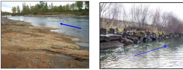
写真 11 河床低下区間の露岩状況 (左: KP160) 河床低下による護岸の機能喪失 (右: KP160.2)
