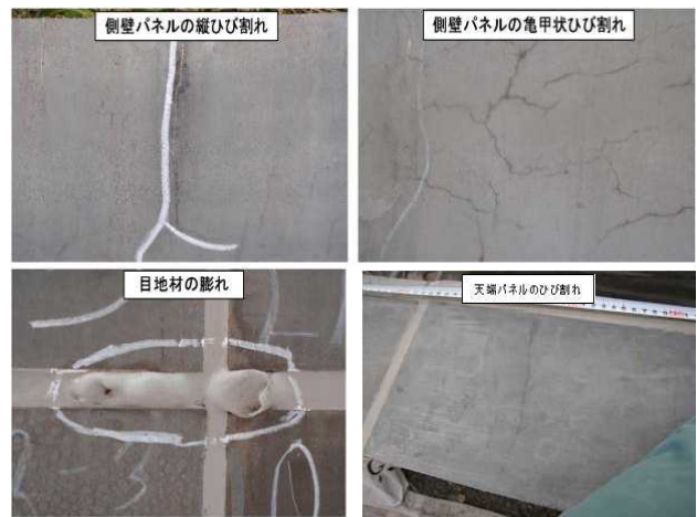
写真-6 高耐久性埋設型枠工法の変状
