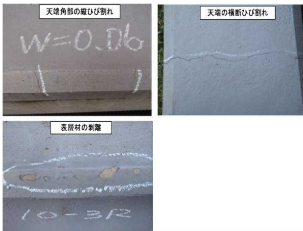
写真-5 レジンモルタル工法の変状
