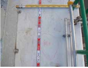
写真-14 土砂吐操作台
