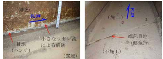
写真-10 工法境界部と端部の目地周りの状況（3号水路橋）
