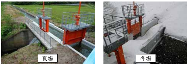
写真-8 1号水路橋補修後の夏場・冬場の状況
