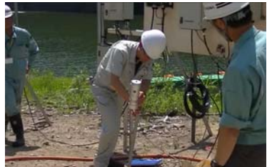
写真-5. 斜面崩壊検知センサー動作確認状況
