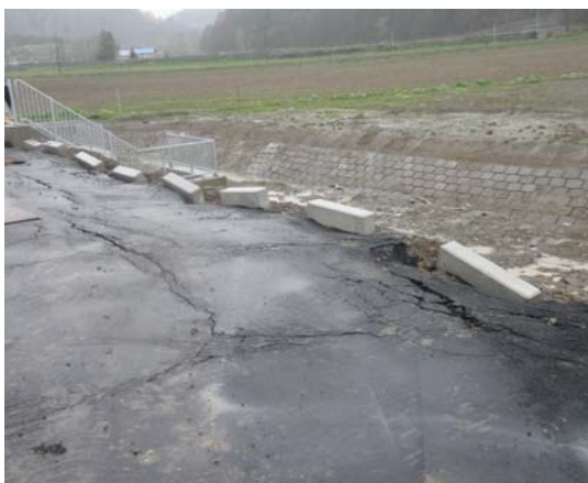
写真-1 冬期盛土変状事例
