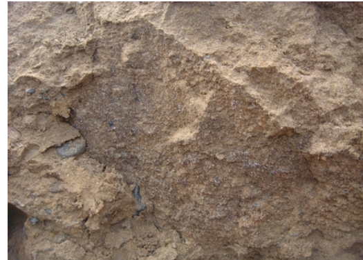
写真-9 開削時に確認された盛土内の粒状の水
