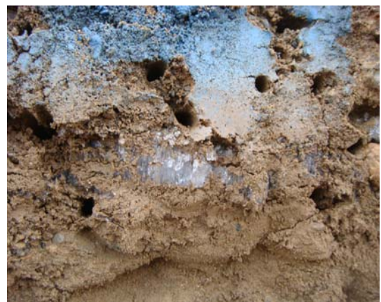
写真-2 盛土内で確認された氷柱
