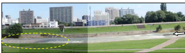
図-3 豊平川5号床止(出水後の土砂堆積) ：土砂
