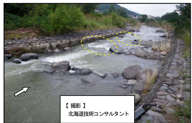
図-6 真駒内川分散型落差工(出水後の石の流失) ：石の流失部分
