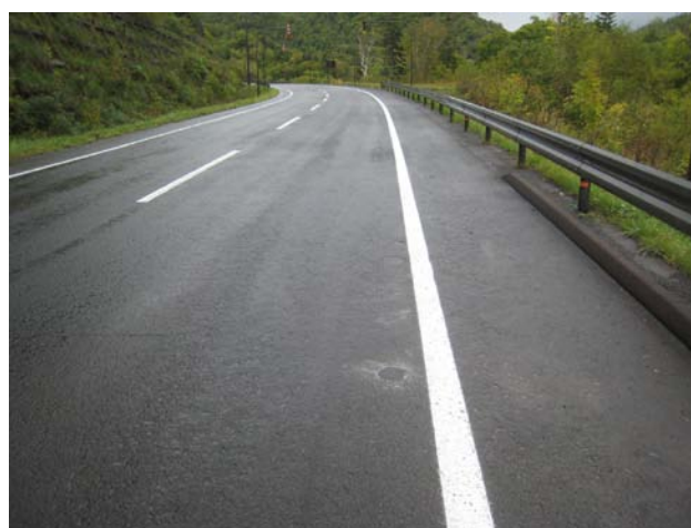
図-4 現地路面状況 (風化安山岩) 2012年10月11日現在
