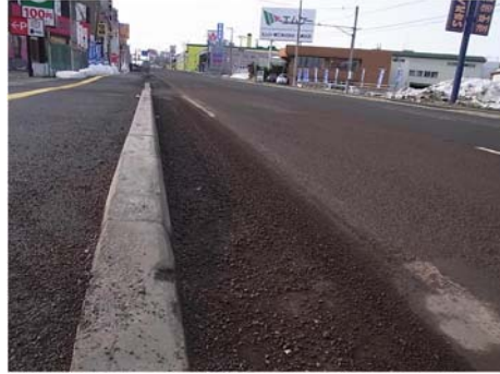
写真-2 除雪車等による骨材飛散
