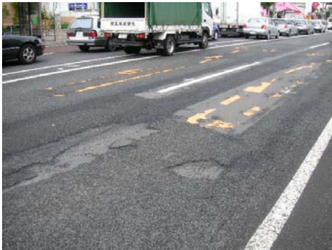
写真-1 排水性舗装の破損状況
