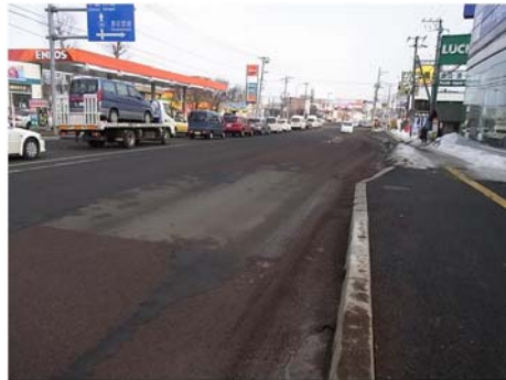
写真-3 車輛の据えきりによる破損
