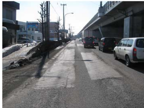
写真-4 車両の発進・停止による破損
