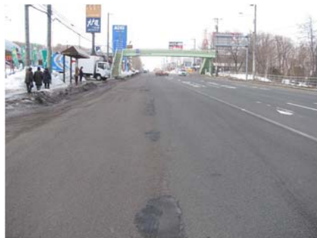
写真-5 施工継ぎ目部の破損
