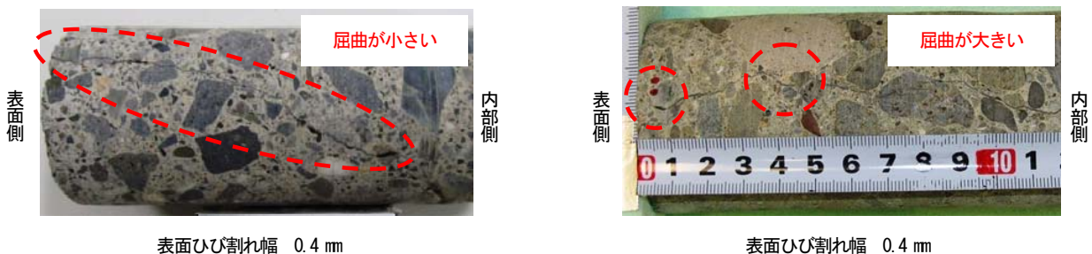
写真-5 エポキシ系注入材の注入充填率が低い削孔コアの例
