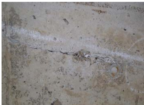
写真-1 注入不足等による再びひび割れの例
