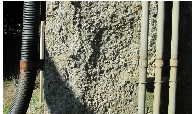
写真-1 凍害の事例 (北海道山間部の道路橋下部)
