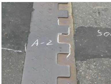
写真-2 A-2側伸縮装置の段差
