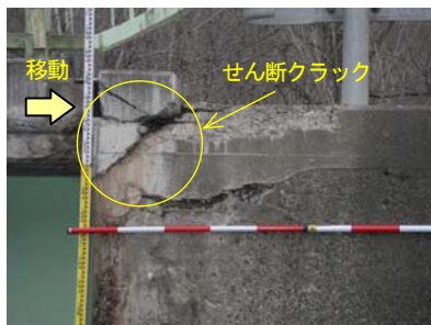
写真-1 A-2胸壁のコンクリート剥離
