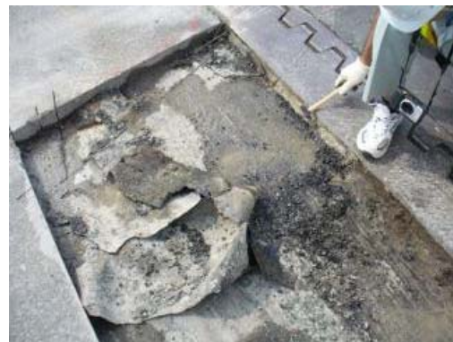
図-1 防水層の損傷例
