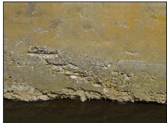
写真-1 試験地の複合劣化状況
